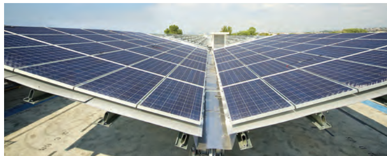
Car Rental Centre : le plus grand toit photovoltaïque des Alpes-Maritimes
